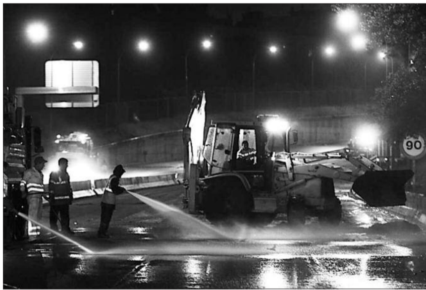
Los bomberos limpian la calzada tras la inundación. / G. L.
